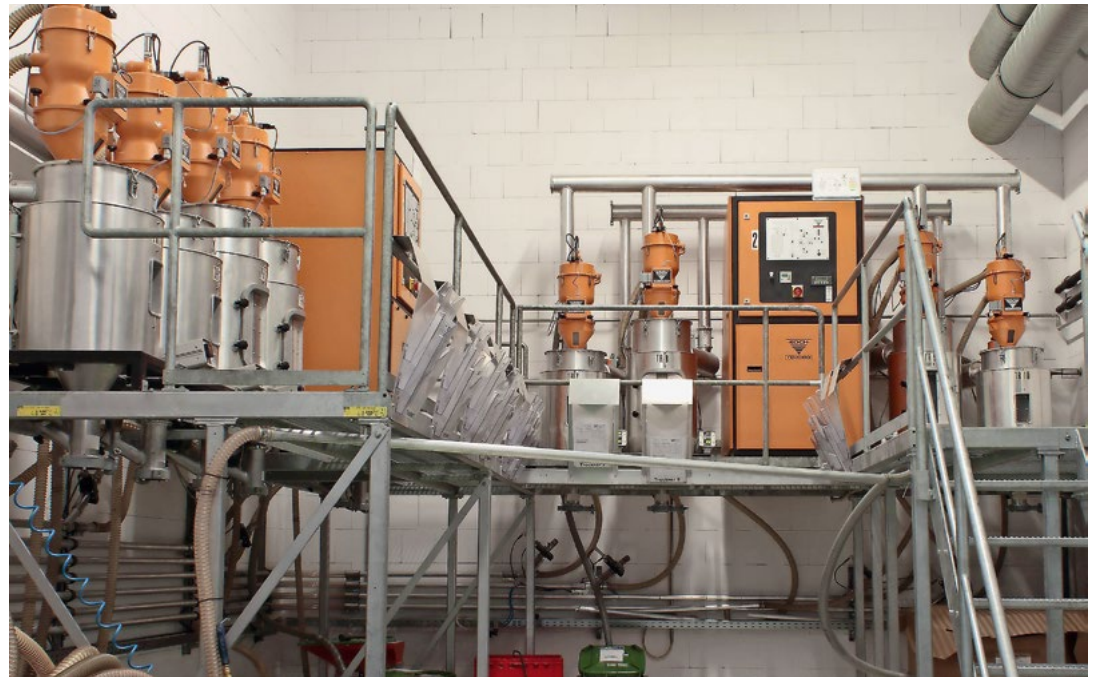
2012 wurde die Produktion von technischen Spritzgussteilen nach Dohma verlagert und die Koch-Trocknungstrockner zogen mit um. Das hygroskopische Granulat wird mit dem CKT-Trockner (2) taupunktgesteuert sicher auf die zur Verarbeitung notwendige Restfeuchte gebracht. Foto: Koch-Technik
